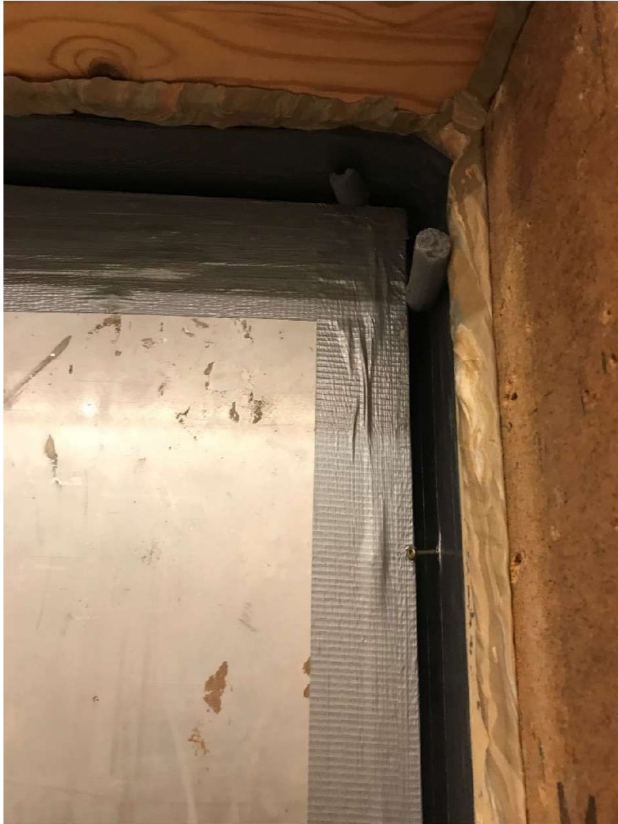
Figur 4: Bild på del av demonterad bottningslist (grå) som användes till en av mätningarna (se Bilaga 3). Springan är 15 mm bred.
